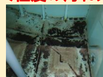
(例)水槽の底に泥やサビが沈積している。
